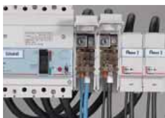
Модульный распределительный блок на 160 А (кат. № 048 87) с полной изоляцией каждого полюса
