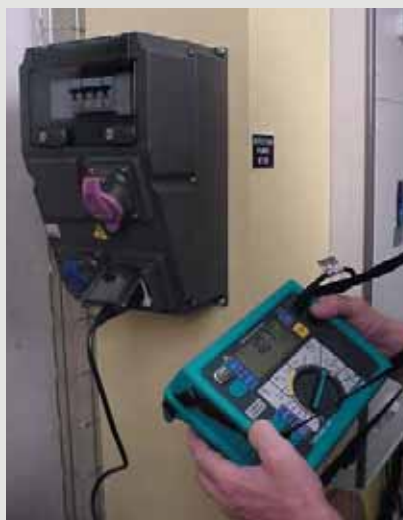
Измерение тока короткого замыкания в конце линии позволяет оценить на практике правильность выбора системы защиты.
