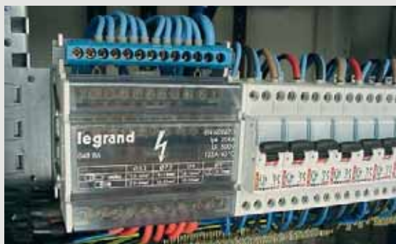
Дополнительный клеммный блок для присоединения нейтральных проводников в распределительном устройстве
