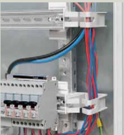
Вертикальный жгут проводов
