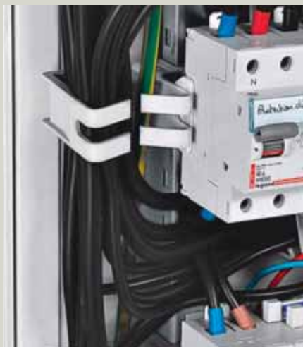
Вертикальный жгут проводов
